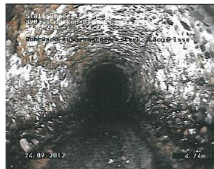
stark ausgewaschene Rohrwand, Längsrisse
