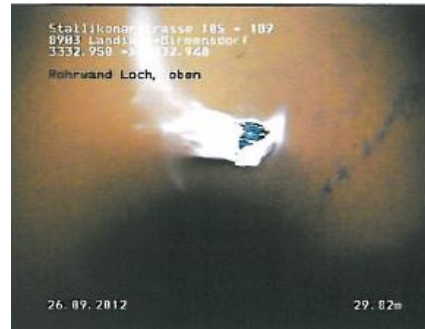
Mechanische Beschädigung von aussen
