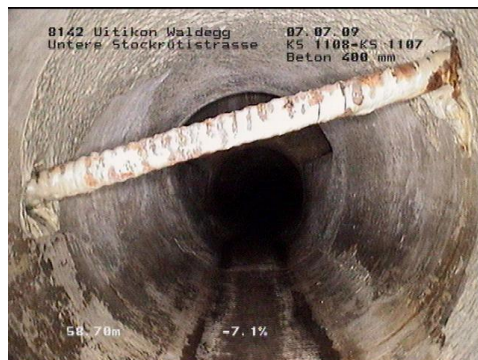
Eisen durchbohrt die Leitung
