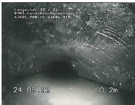
Stehendes Wasser: lokal Leitungsabsenkung
