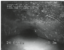
Stehendes Wasser: lokale Leitungsabsenkung
