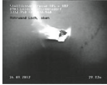
Mechanische Beschädigung von aussen
